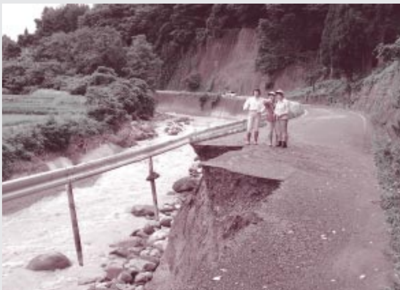
楠川の決壊により大きく削られた県道の災害現場にかけつける (8月10日・戸隠日照田地籍)
