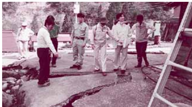
土台からひび割れした住宅にはレッドカードがはられていました。
